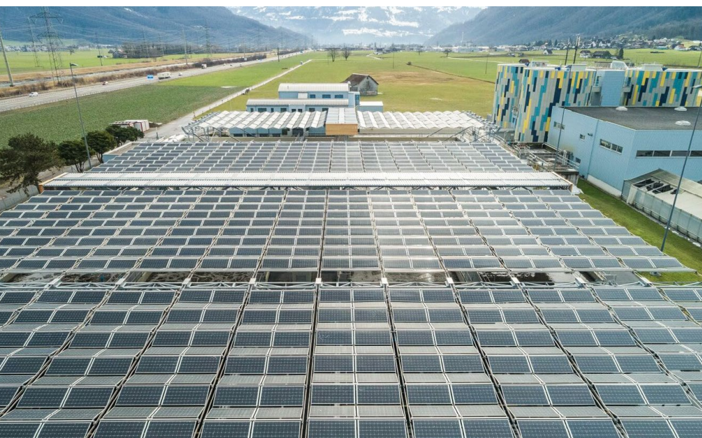
Solarfaltdach auf der Kläranlage in Bilten/GL mit 817,9 kWp installierter Leistung
